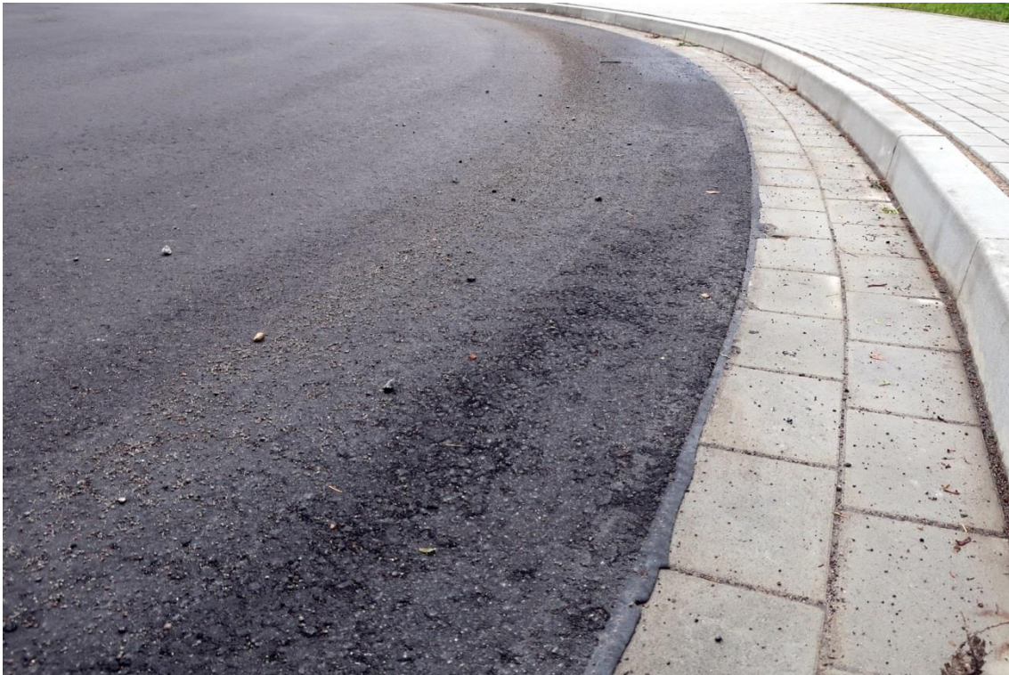
Abb. 1: Abrieb am Außenrand erhöht die Gefahr von Stürzen durch Wegrutschen.
