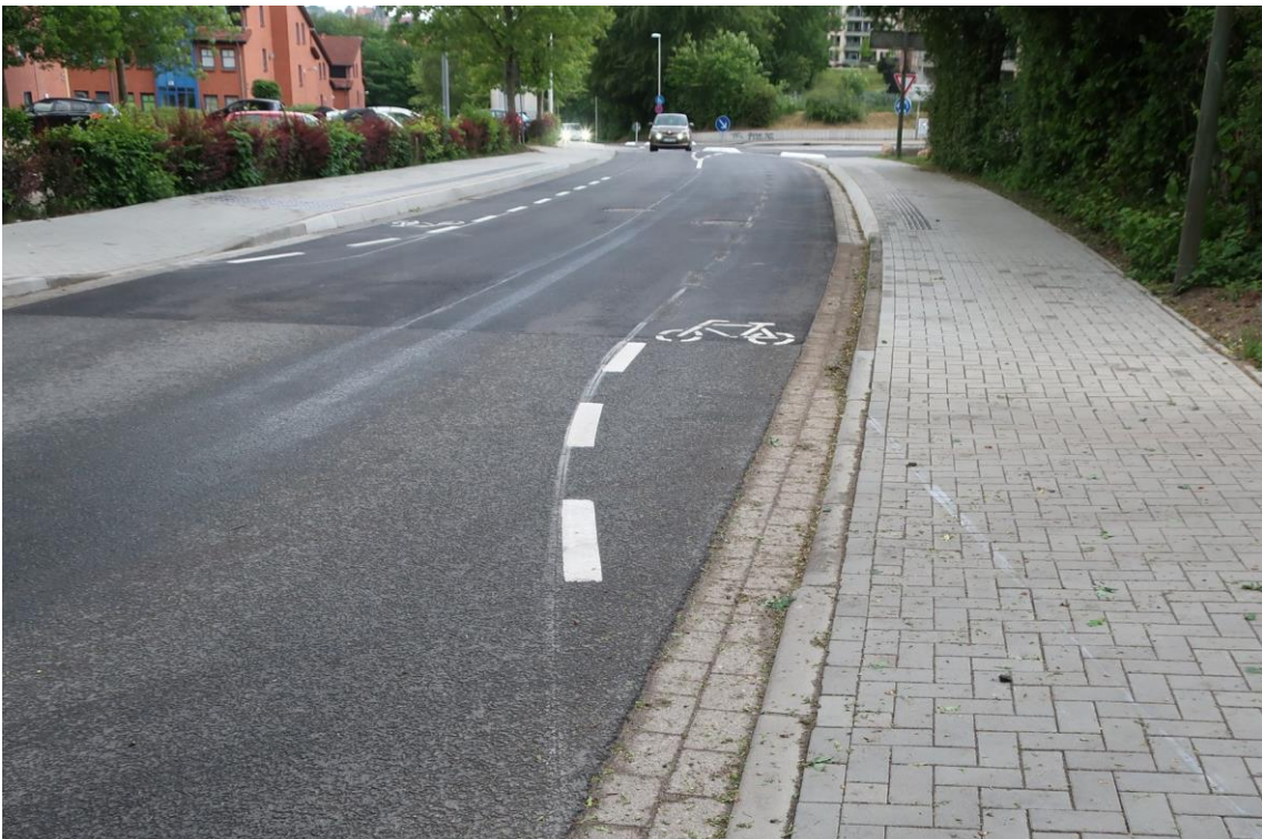
Abb. 12: Gefährliche Einfädelspur, obere Seite des Kreisverkehrs (Munketoft).
